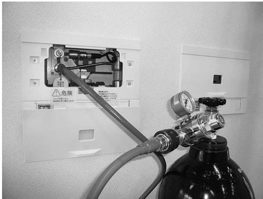
図4 緊急導入口付き遮断弁とそこからの医療ガスの導入
