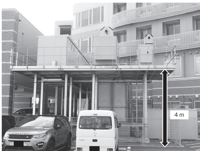
図2 浸水を想定して高上げた架台に設置したキュービクルと自家発電装置 〔写真提供：高瀬正章氏（まび記念病院臨床工学科）〕
