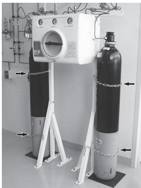
図1 高圧ガス容器の上下2カ所をチェーンで固定した例
