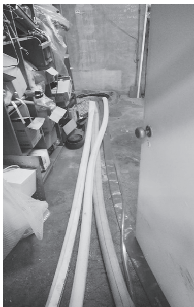
図 4 本館貯水槽への給水 写真奥のマンホールから貯水槽へ給水した。
